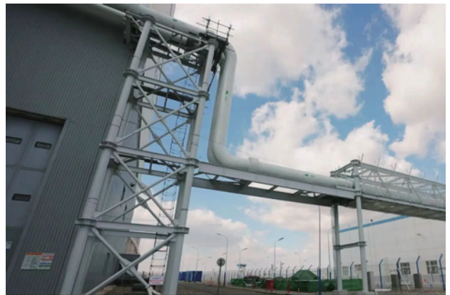
“暖核一号”厂内输热管道
