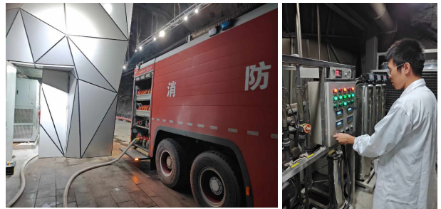
图3 一吨原型机的纯水来自于消防供水，并经过纯水机纯化
